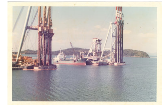
埋立前に海底の地盤を固める工事(サンドコンパクション)1980年代前半
